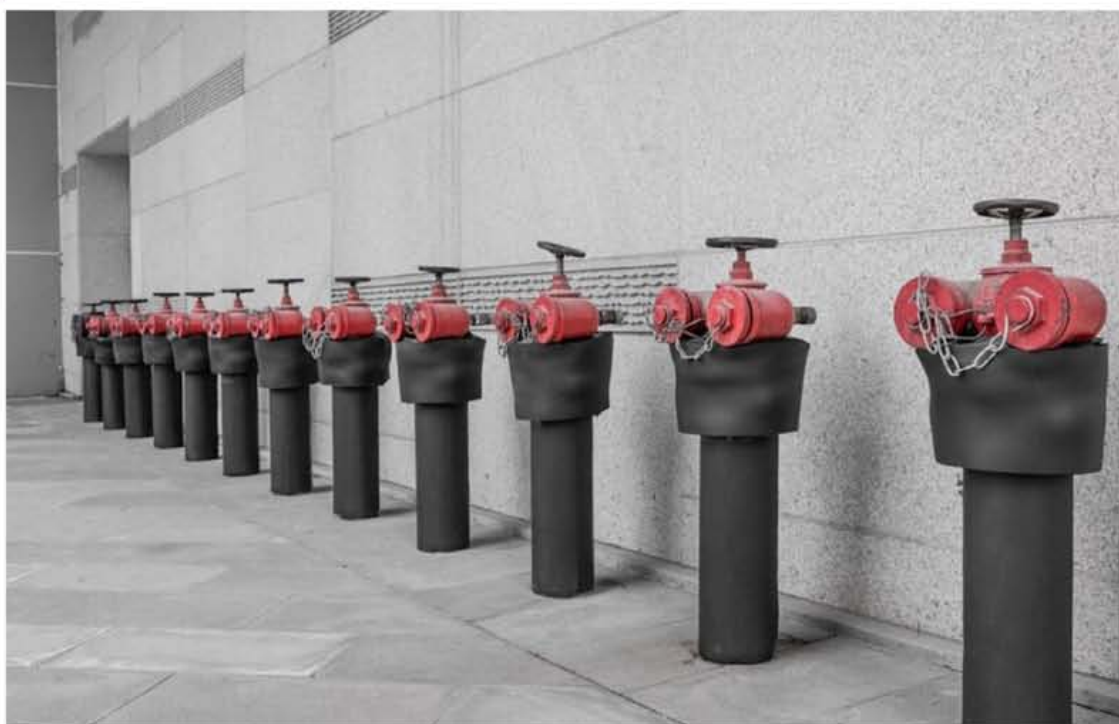
Bocas de incendio
