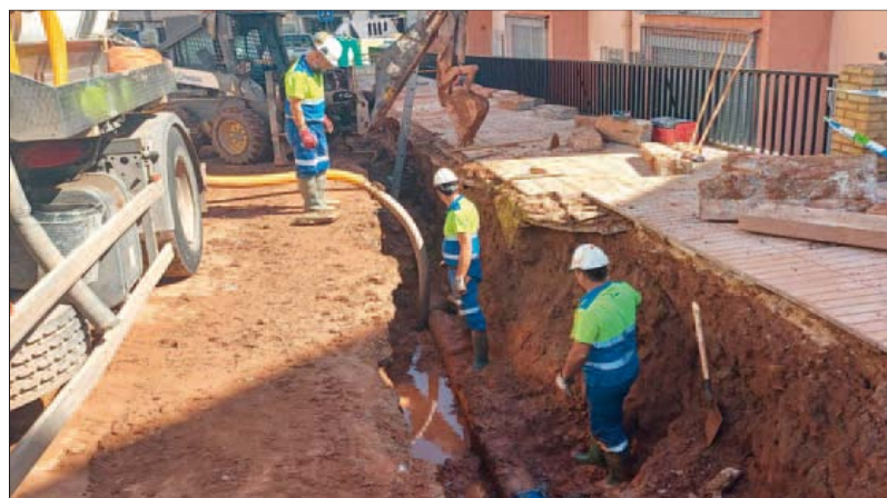
TRABAJOS. Tras la reparación de una avería, la tubería comenzó a perder agua por otros tramos.
